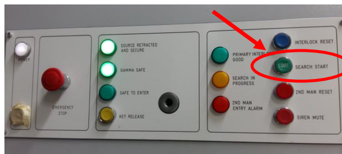
ภาพที่ 3.34 แผงหน้าตู้ควบคุมตรวจสอบว่าไม่มีบุคคลใดอยู่ในห้องฉายรังสี
