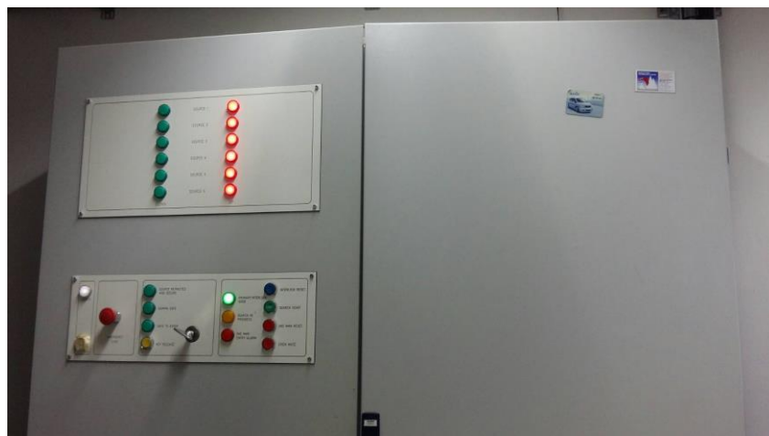
ภาพที่ 3.5 ระบบตู้ควบคุม
