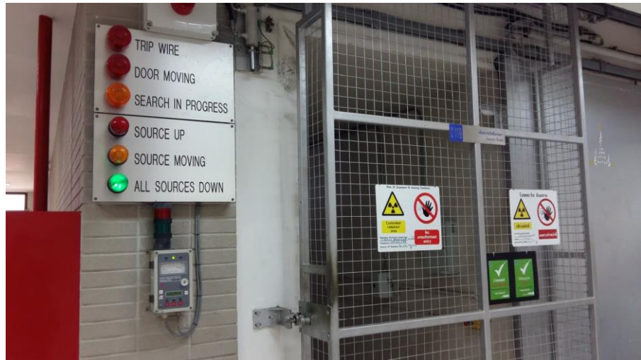
ภาพที่ 3.37 ปิดประตูกรงเหล็กห้องฉายรังสีแกมมา
