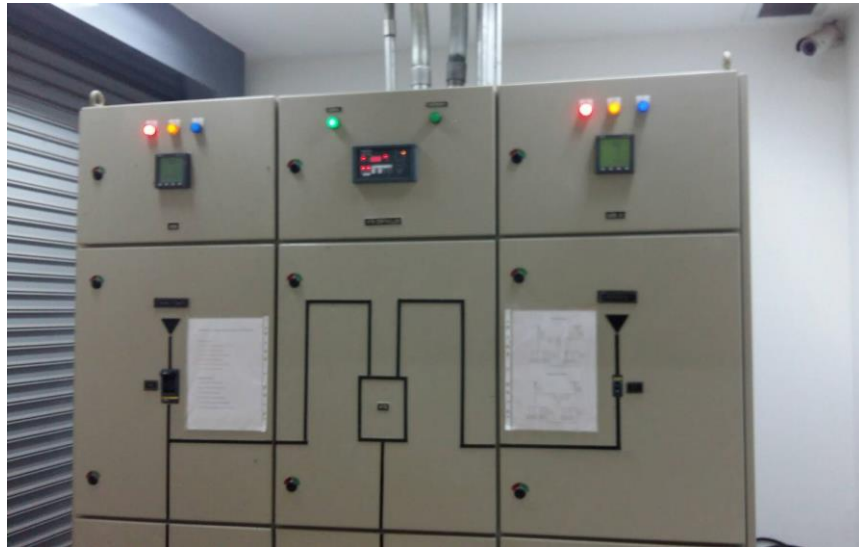
ภาพที่ 3.6 ห้องระบบไฟฟ้า
