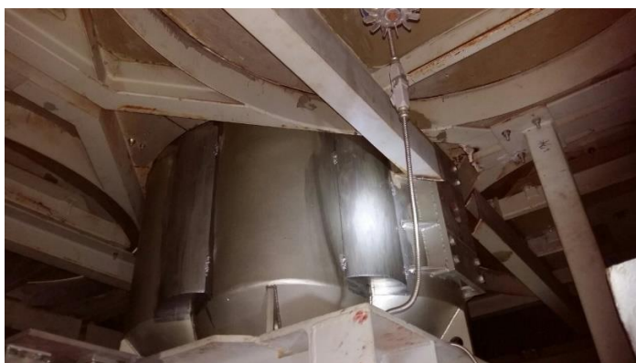
ภาพที่ 3.13 ถังเก็บต้นกำเนิดรังสี แบบ Dry storage
