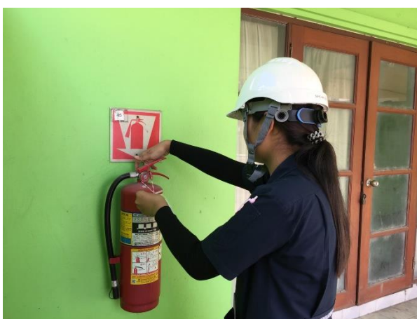
ภาพที่ 1-32 ตรวจสอบถังดับเพลิง
