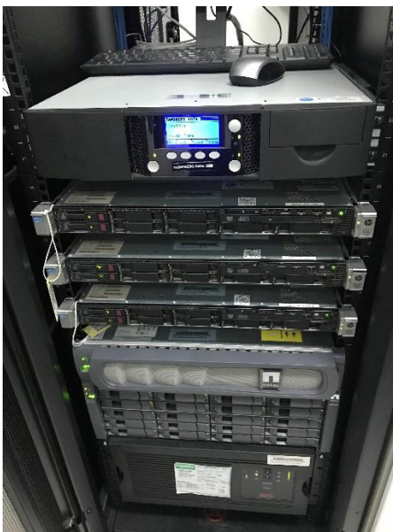
ภาพที่ 4.56 ตรวจสอบห้องเซิร์ฟเวอร์ เพื่อเช็คคุณสมบัติของห้องและตรวจสอบการขัดข้อง
