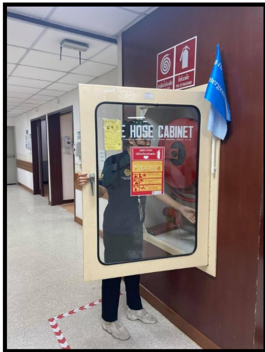
ภาพการตรวจถังดับเพลิง
