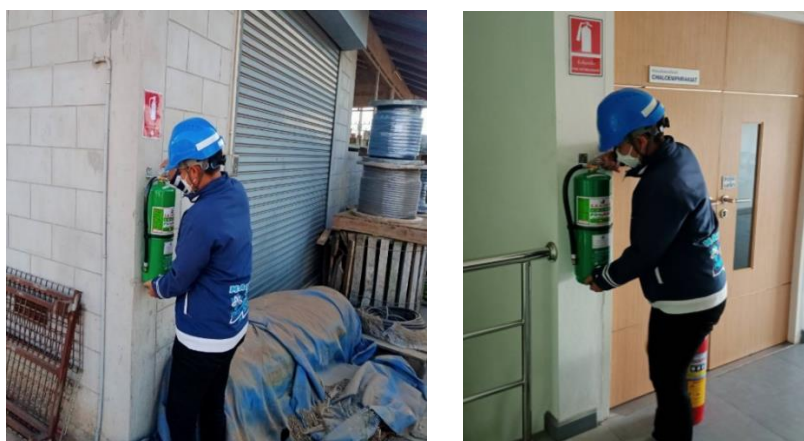
ภาพที่ 1.10 ติดตั้งถังดับเพลิงเพิ่มเติม ในบริเวณที่ยังไม่มีการติดตั้ง
