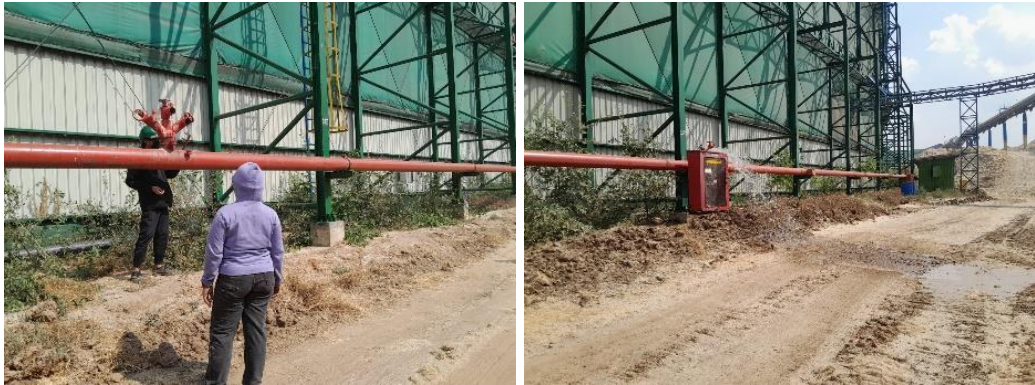
ภาพที่ 28 ตรวจสอบเช็คสภาพถังดับเพลิง ตู้ดับเพลิง และหัวจ่ายน้ำดับเพลิงรอบโรงงาน
