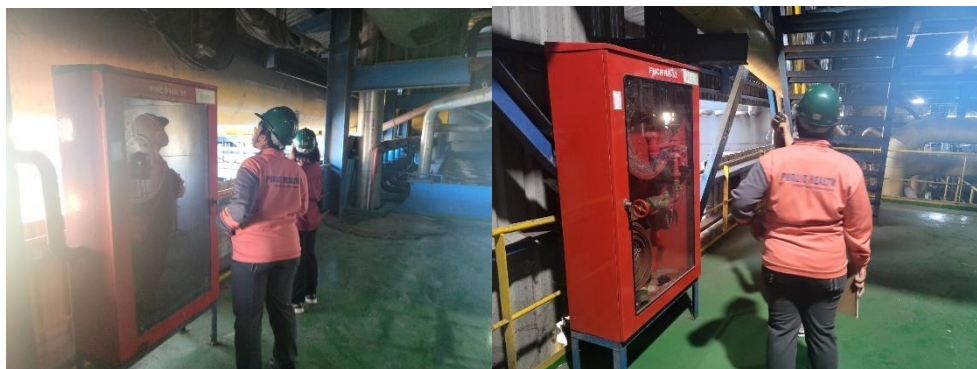
ภาพที่ 30 ตรวจสอบเช็ค Fire Alarm และ ตรวจสอบเช็คอุปกรณ์ดับเพลิงในกระบวนการผลิต
