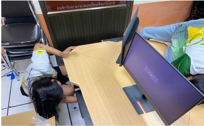
ภาพที่ 14 ติดตั้งเครื่องคอมพิวเตอร์ และลง windows ที่โรงเรียนเตรียมอุดมม่น้อมเกล้านครราชสีมา
